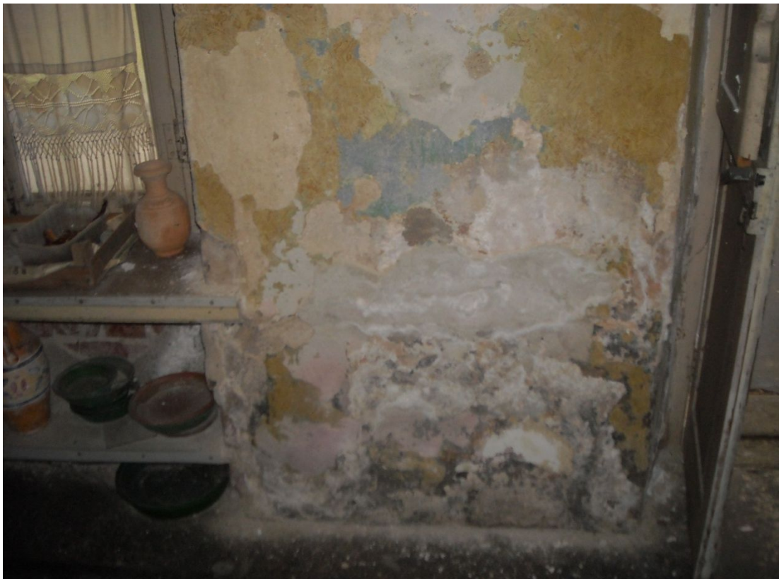
Particolare murature ammalorate fabbricato A
