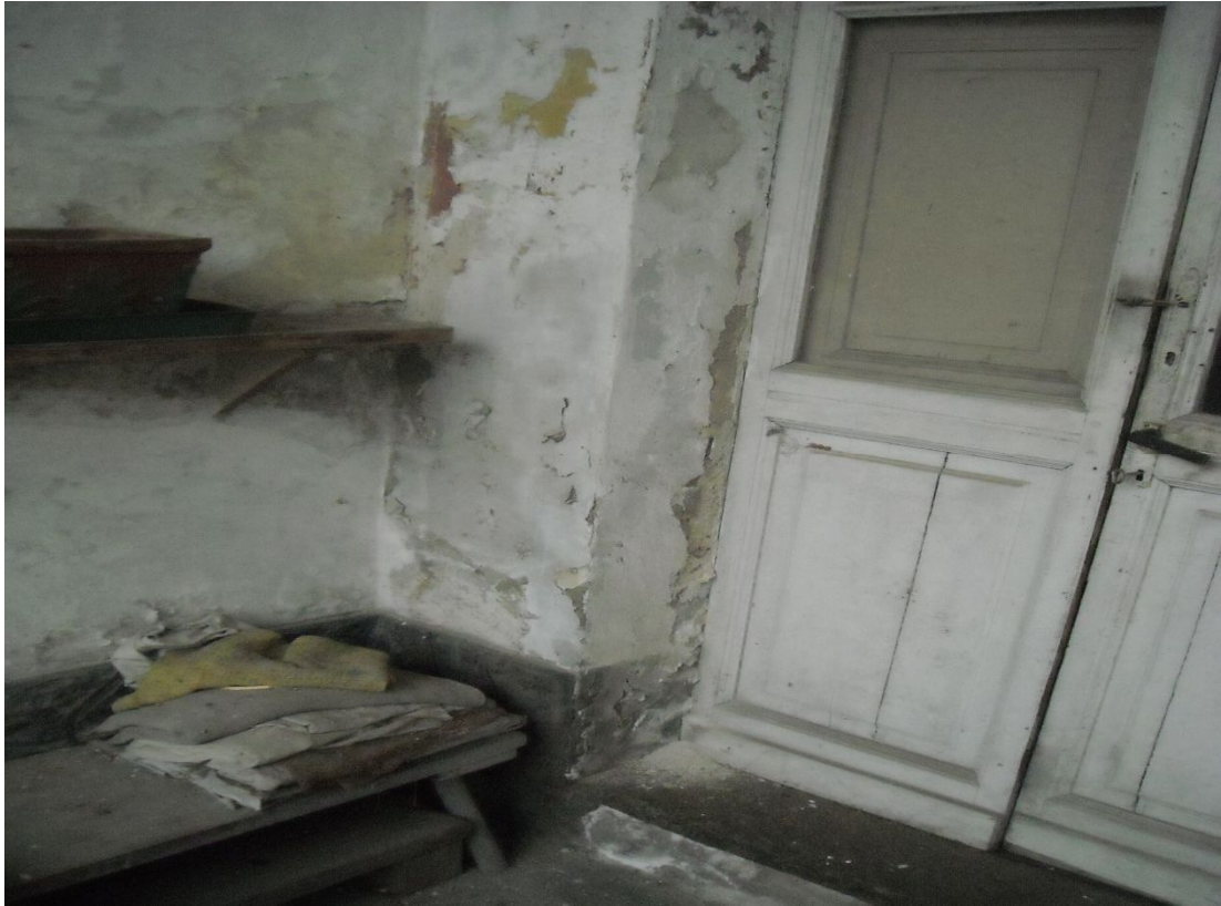
Particolare murature esterne ammalorate fabbricato A
