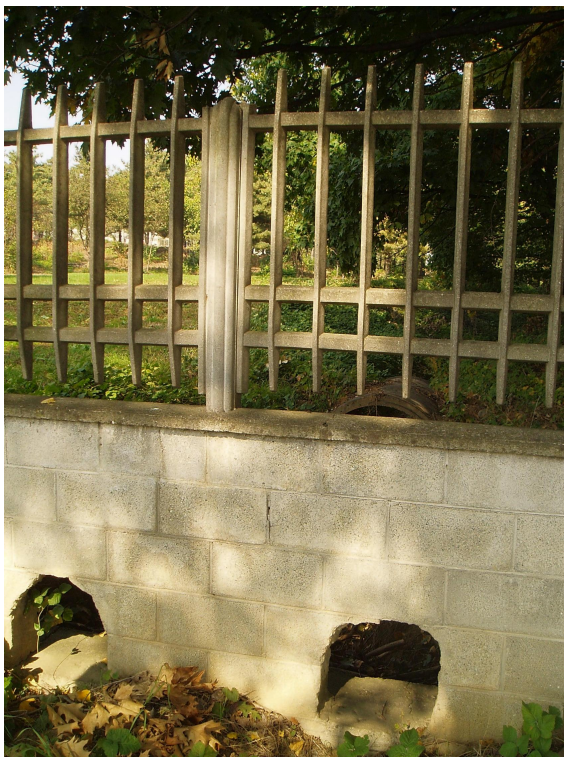
Figura 2-18 – Vista da valle del “dispositivo” di controllo delle acque della Bealera San Luigi unite a quelle della Bealera di Gonzole all’uscita dalla recinzione lungo il lato meridionale dell’Ospedale San Luigi (foto 923-PA100012)
