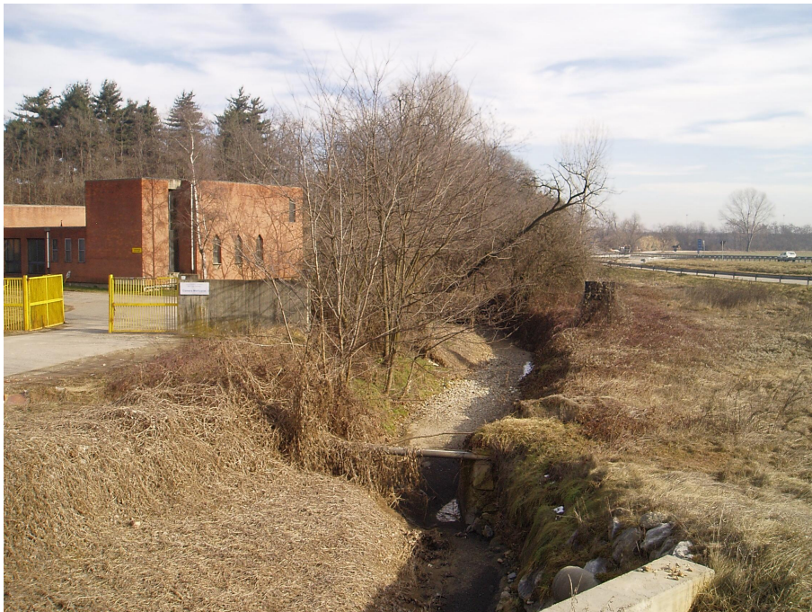
Figura 2-20 – Alveo del Garosso di Rivoli, visto verso valle, all'altezza delle camere mortuarie dell'ospedale San Luigi (a sinistra della foto). L'alveo è inadeguato alla portata di riferimento, che determina l'allagamento dell'area adiacente alla sponda destra fin contro la SP 132 (foto 1213-P2050223).
