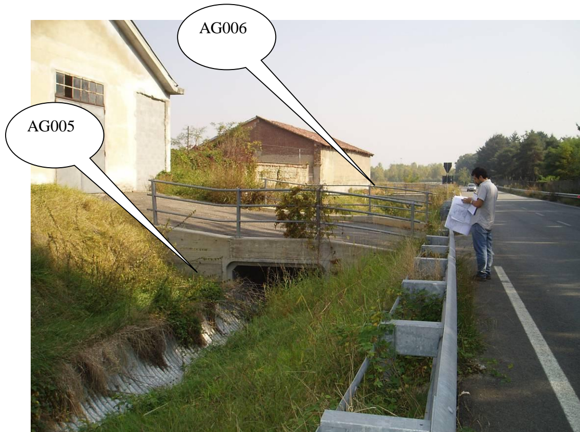
001ANSEAG005 e AG006 – Vista da monte (foto 923-PA100015) sul manufatto 005 e 006 – Scatolare e canaletta in lamiera corrugata. I due manufatti sono identici. La canaletta in lamiera corrugata ha 1.60 m di diametro.
