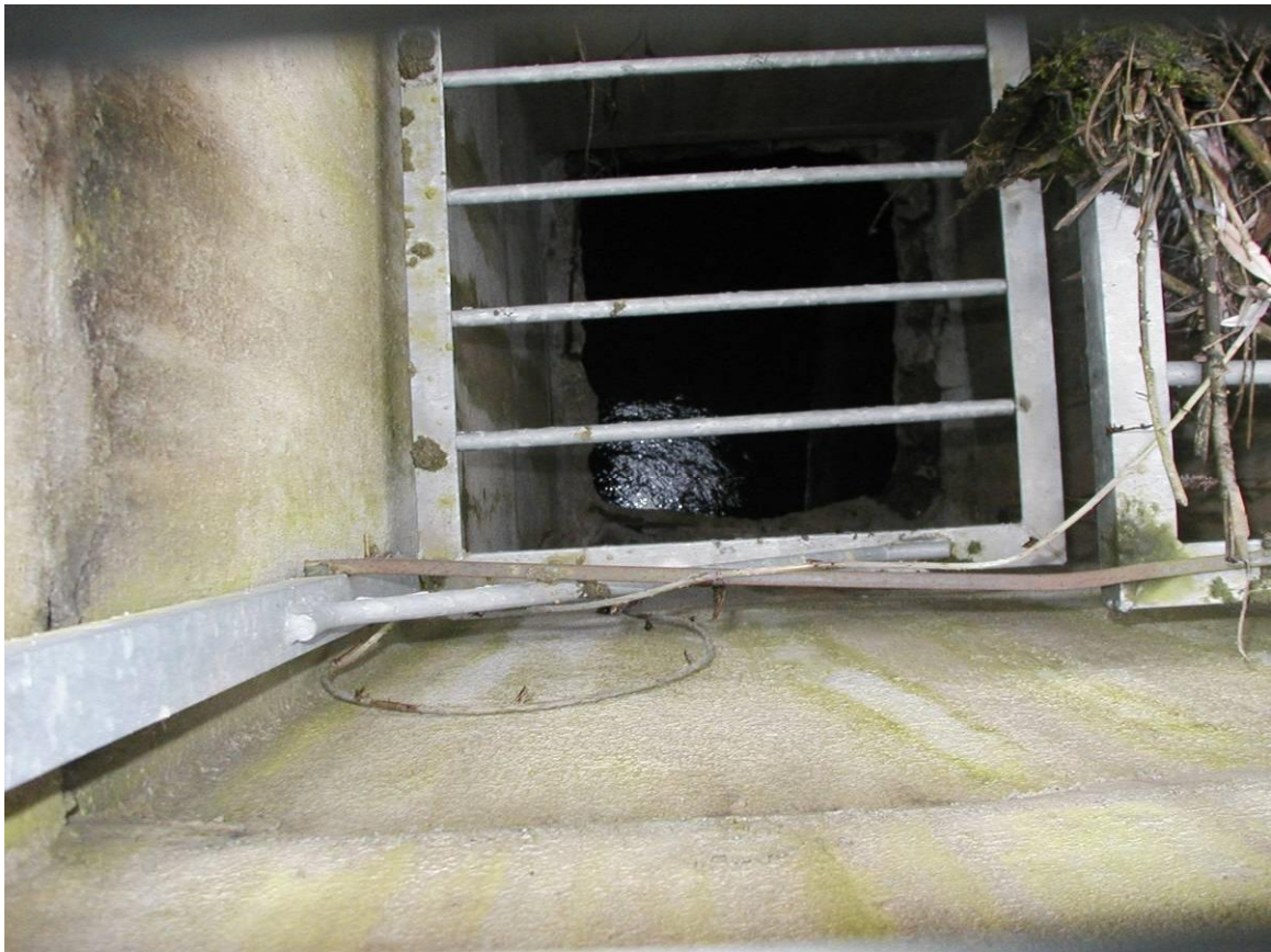
001ANSESCG001 – Scarico verso lo scolmatore del SITO (gennaio 2003)
