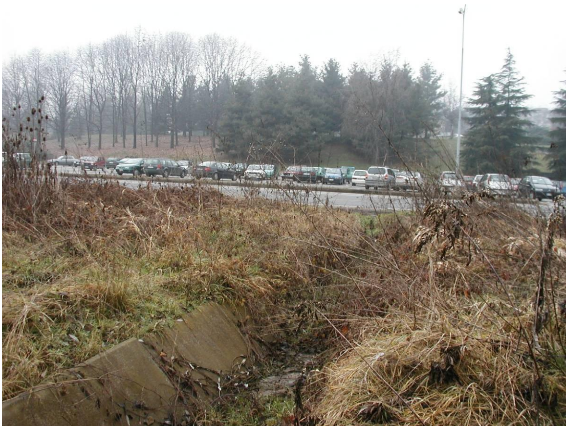
002ANSESCG001 – Canaletta accessoria allo scarico (gennaio 2003)
